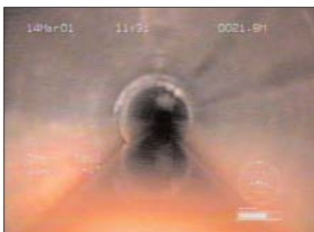
Fig. 23: Compensorio irriguo del Tufano: interno tubazione esistente in cemento amianto - cattiva posa con controtendenza
