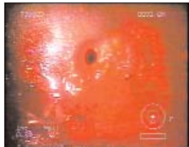
Fig.2: Particolare della corrosione in un tubo in acciaio
